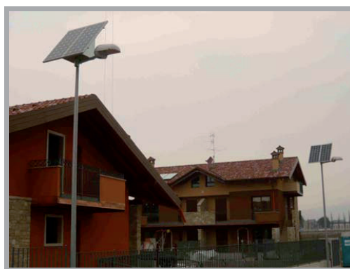
Figura 16 - Lampade a luce diretta con pannello fotovoltaico
