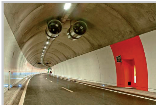
Figura 64 - Illuminazione di galleria ad una fila di apparecchi
